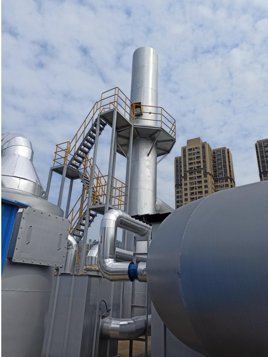
废气治理设施
