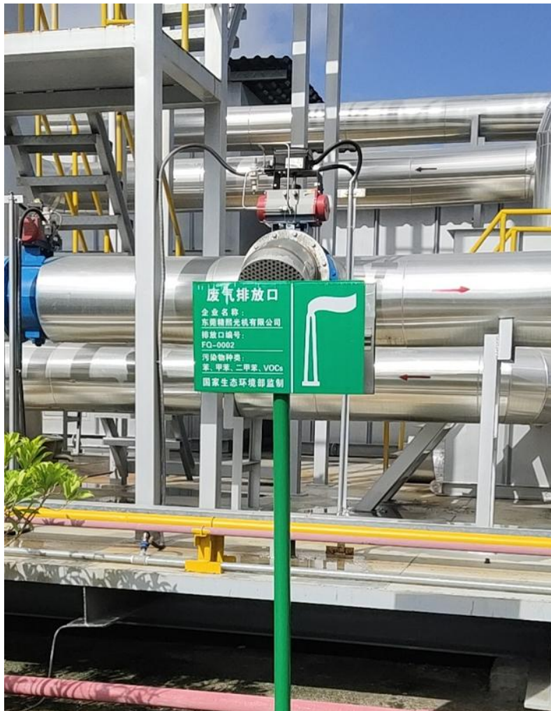
排放口标识牌
